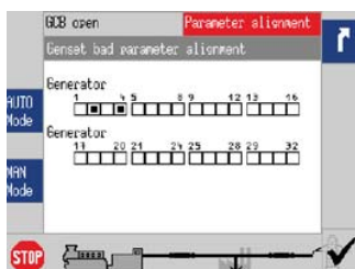
Fig. 163: Genset bad parameter alignment screen
